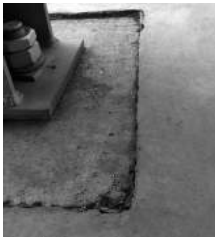
1. kép A duzzadó agyagrégteg több cm-rel megemelte a betonlemez
