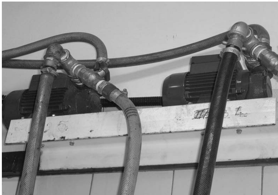
2. ábra Adalékszer szivattyúik a Holcim Hungária Zrt. Kőbányai Betongyárában
