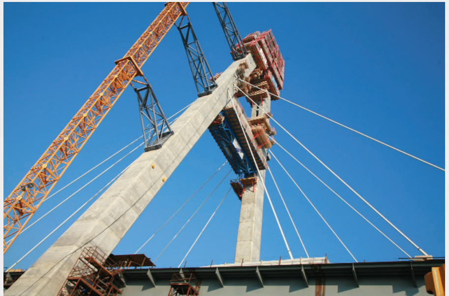
2. ábra A 6. számú pilon, 3-3 befűzött kábellel
