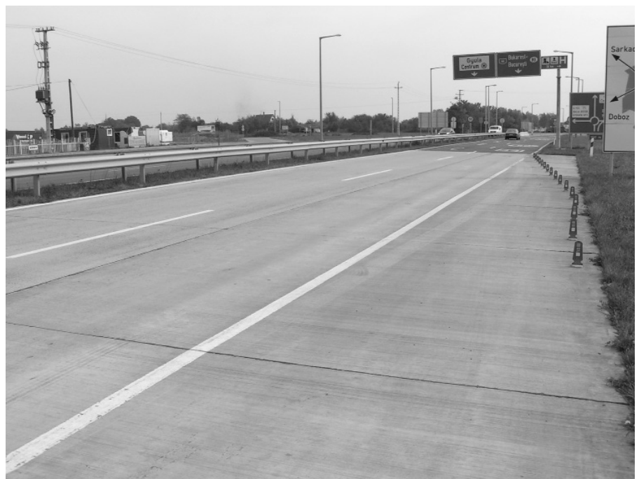
1. ábra A 44. út Gyula város felőli betonburkolatú szakasza
