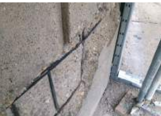
1. kép A vasbeton szerkezet állapota
