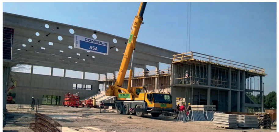
10. kép Az acél rácsos tartókat felváltó vasbeton váz, mely „kiütötte a biztosítékot”
