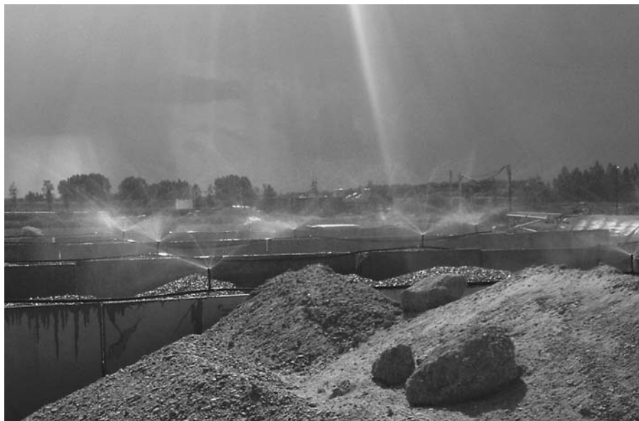
4. ábra Kavicsshűtés vízpermettel - működés közben
