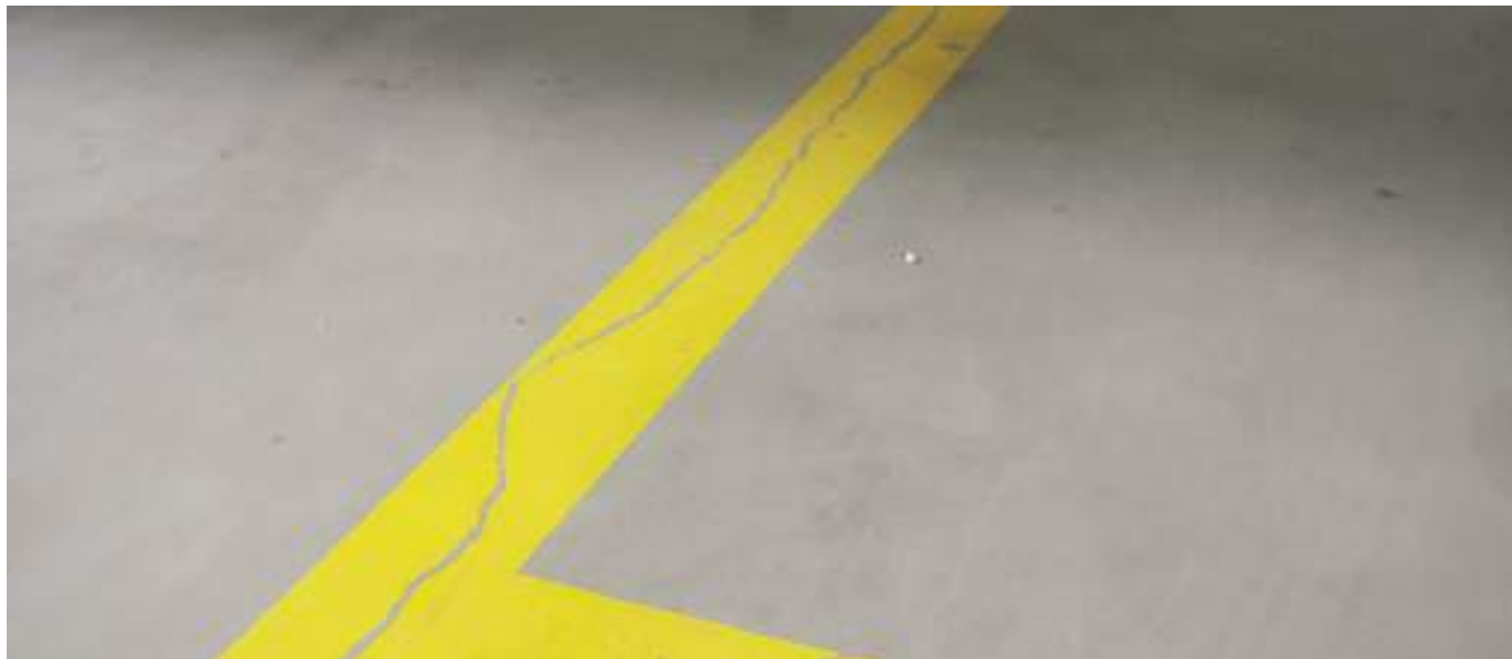
2. kép: Javított repedés
