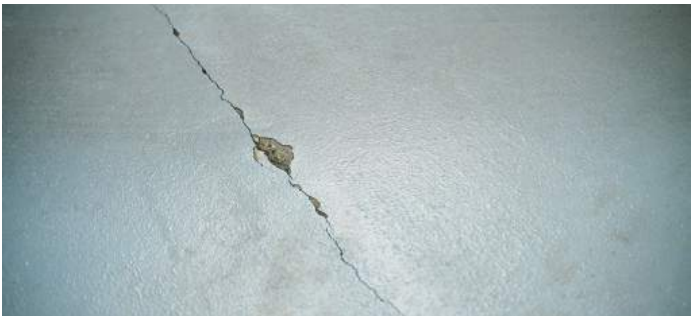
1. kép: Repedés és kirepedés
