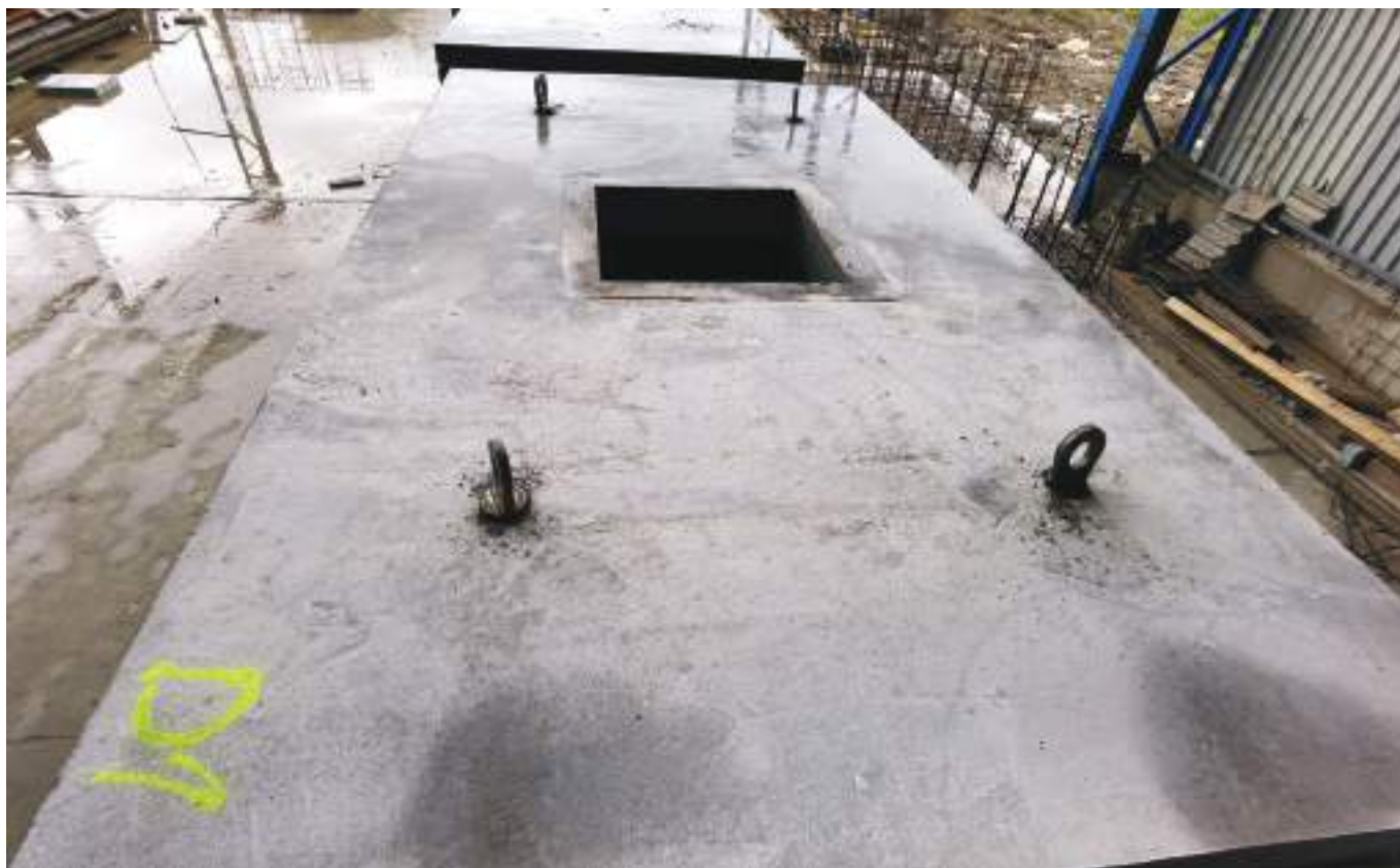
Nehézbeton kész tároló D1 jelű
