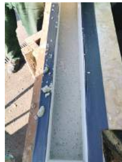
1. kép Öntömörödő beton légtelenedése
