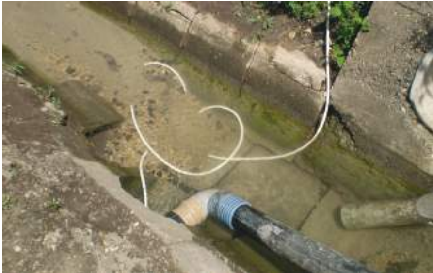
Hosszabító a vízben vezetve
