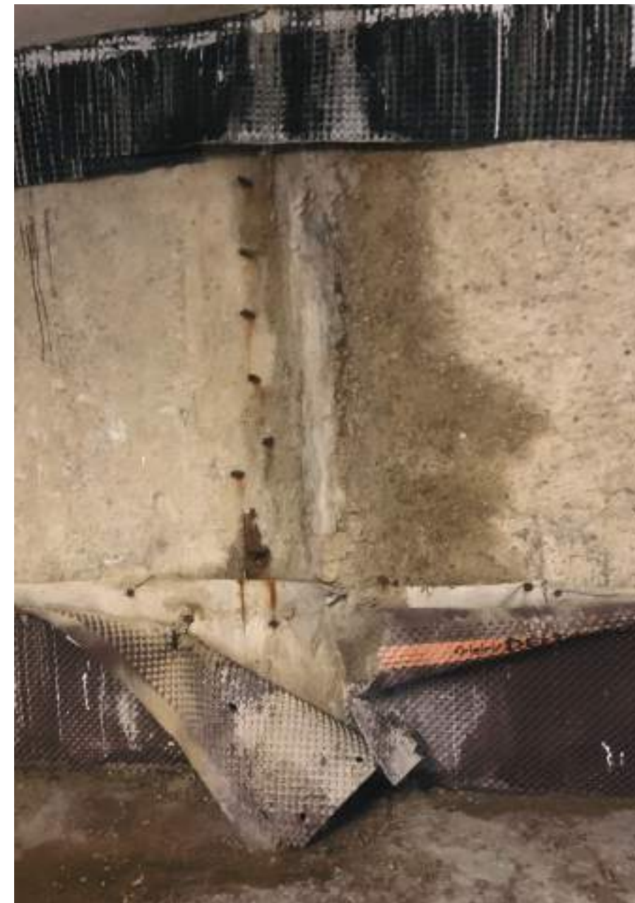
3.kép: Mélygarázsban a résfal munkahézagánál nincs meg a megfelelő vízzáróság és a beton is túlzott mértékben átázott.
