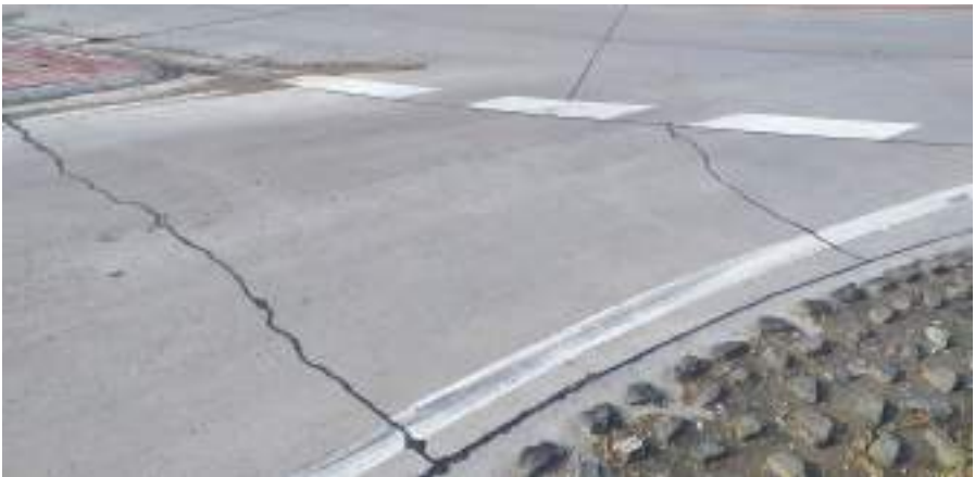
2. kép - A gyulai körforgalom csatlakozó táblájának lezárt repedései - (fotó: Dr. Bencze Zsolt)
