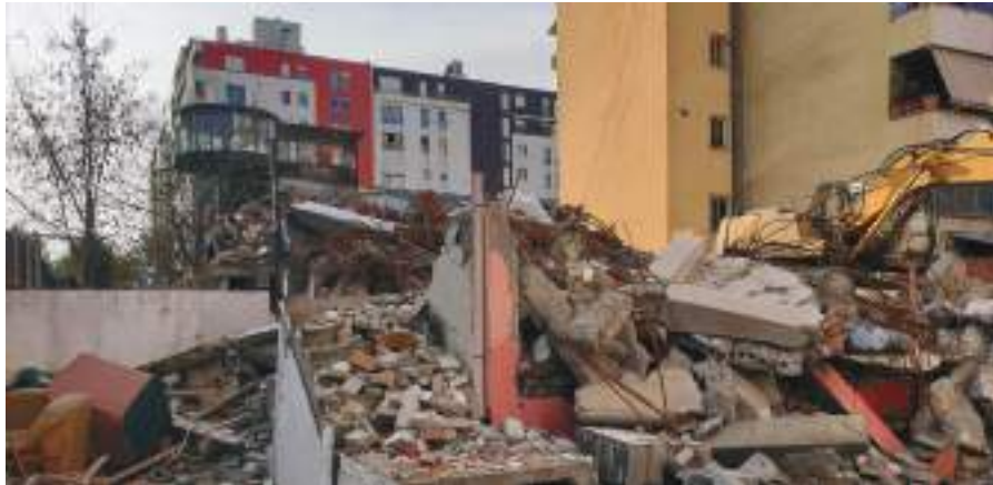
1b. ábra A 2019-es tiranai földrengésben sérült épület
