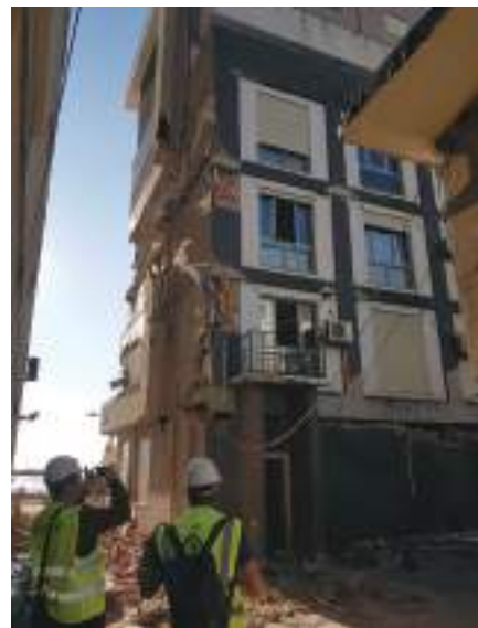
1a. ábra A 2019-es tiranai földrengésben sérült épület
