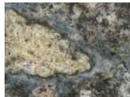
4. kép - Alkáli-szilika reakció betonon
