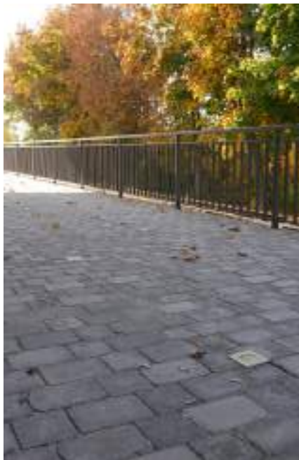
Burkolatba épített világítás az épület mögötti sétányon
