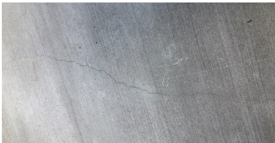
3. kép: Jellemző a korai zsugorodási repedésekre, hogy szabálytalan a vonalvezetésük. Vannak olyan repedések, amelyek tágassága csökken és a repedés nem fut ki a táblaszélig.
