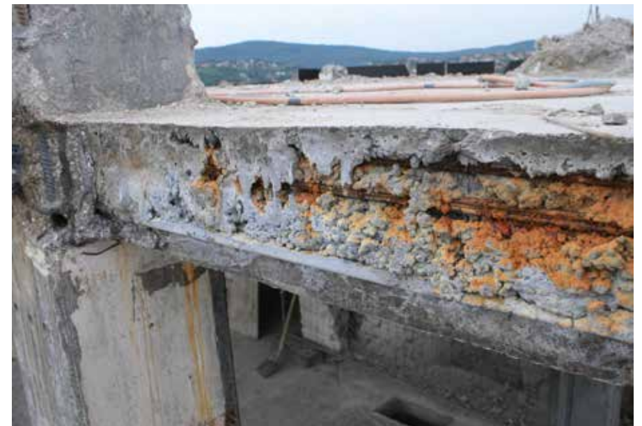
▲ A korrodált feszítő pászmák a tömörítetlen kábelcsatornában [2]
