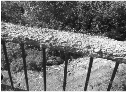
1. ábra Fagykárosodott vasalt beton hídkorlát
