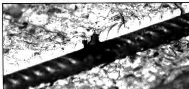
4. ábra A \tau = 1,60 (a), illetve \tau = 2,05 (b) mérési helyeken feltárt vasalás korróziója. Az ezektől távoli, korróziómentes helyeken \tau = 13,5 volt.
