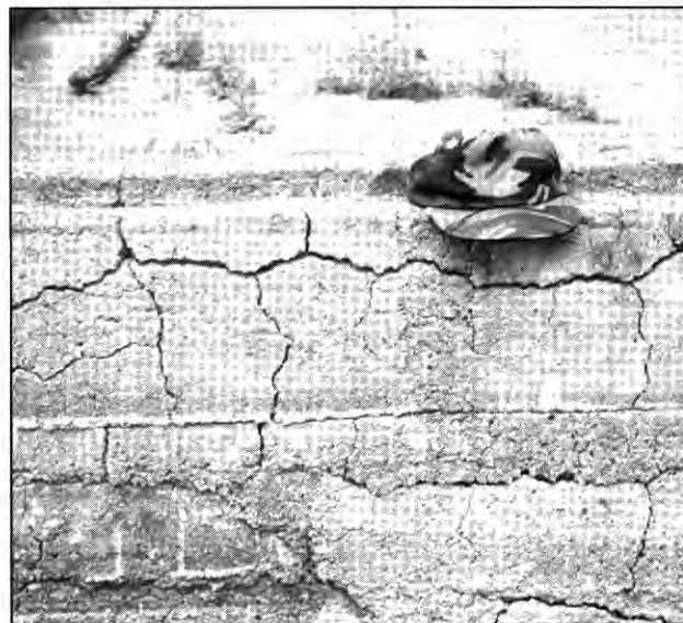
2. ábra Makrorepedések a betonban
