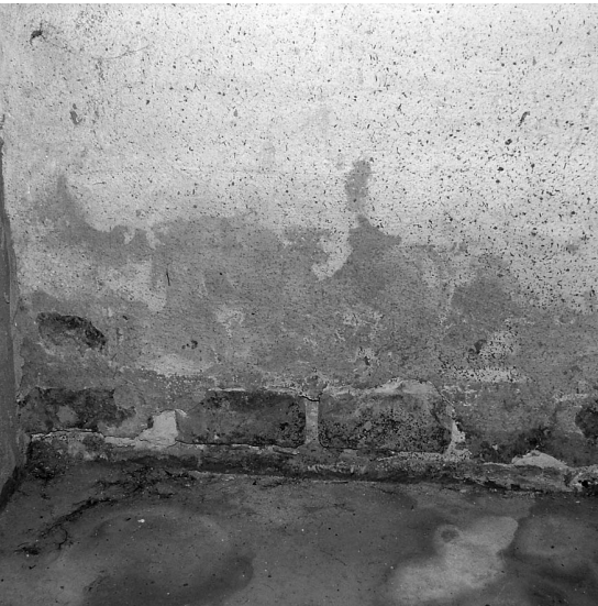
4. kép Nedvesség okozta károsodás a pincében
