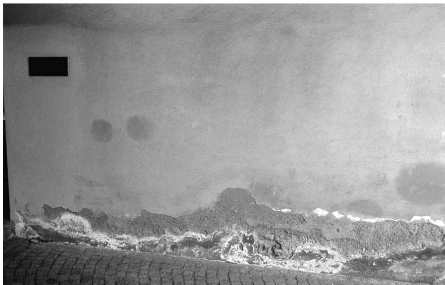
1. kép A víz és a só tönkreteszi a falszerkezetet és a felületet
