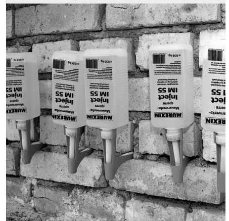
9. kép Az injektáló anyag beszívargása a szerkezetbe
