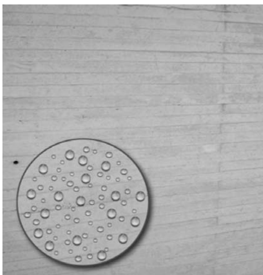
2. ábra Víztaszító anyaggal kezelt betonfelület
