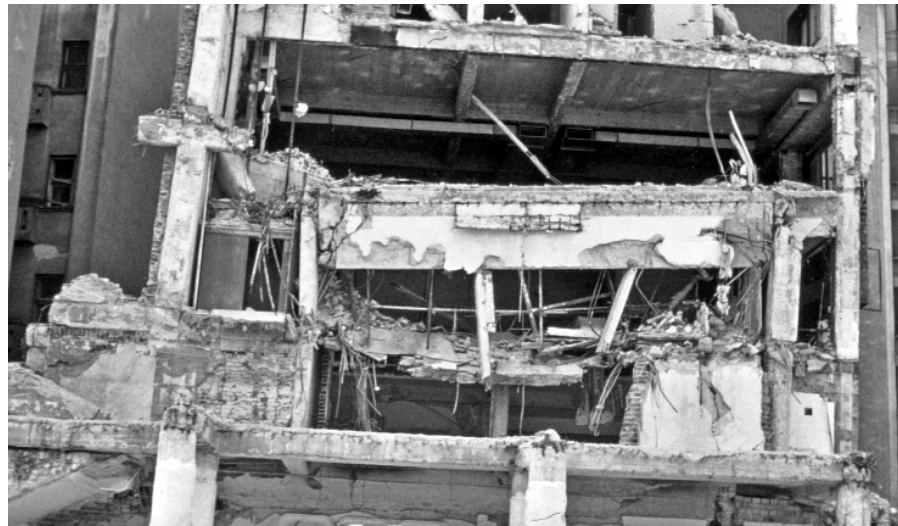
1. ábra Megrongálódott épület
