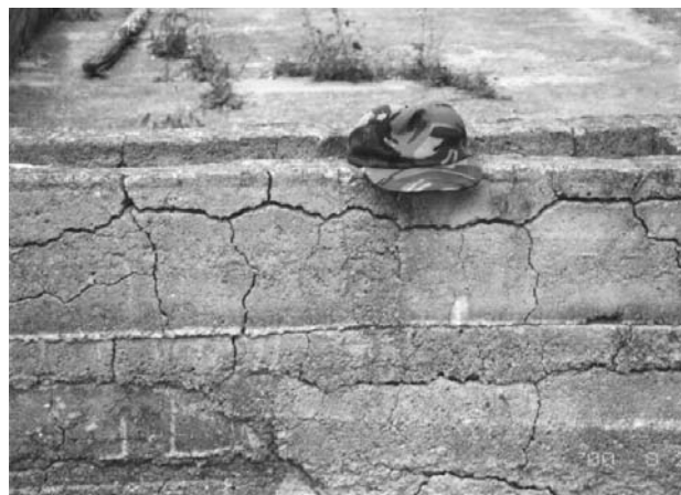
1. ábra Repedések a falon
